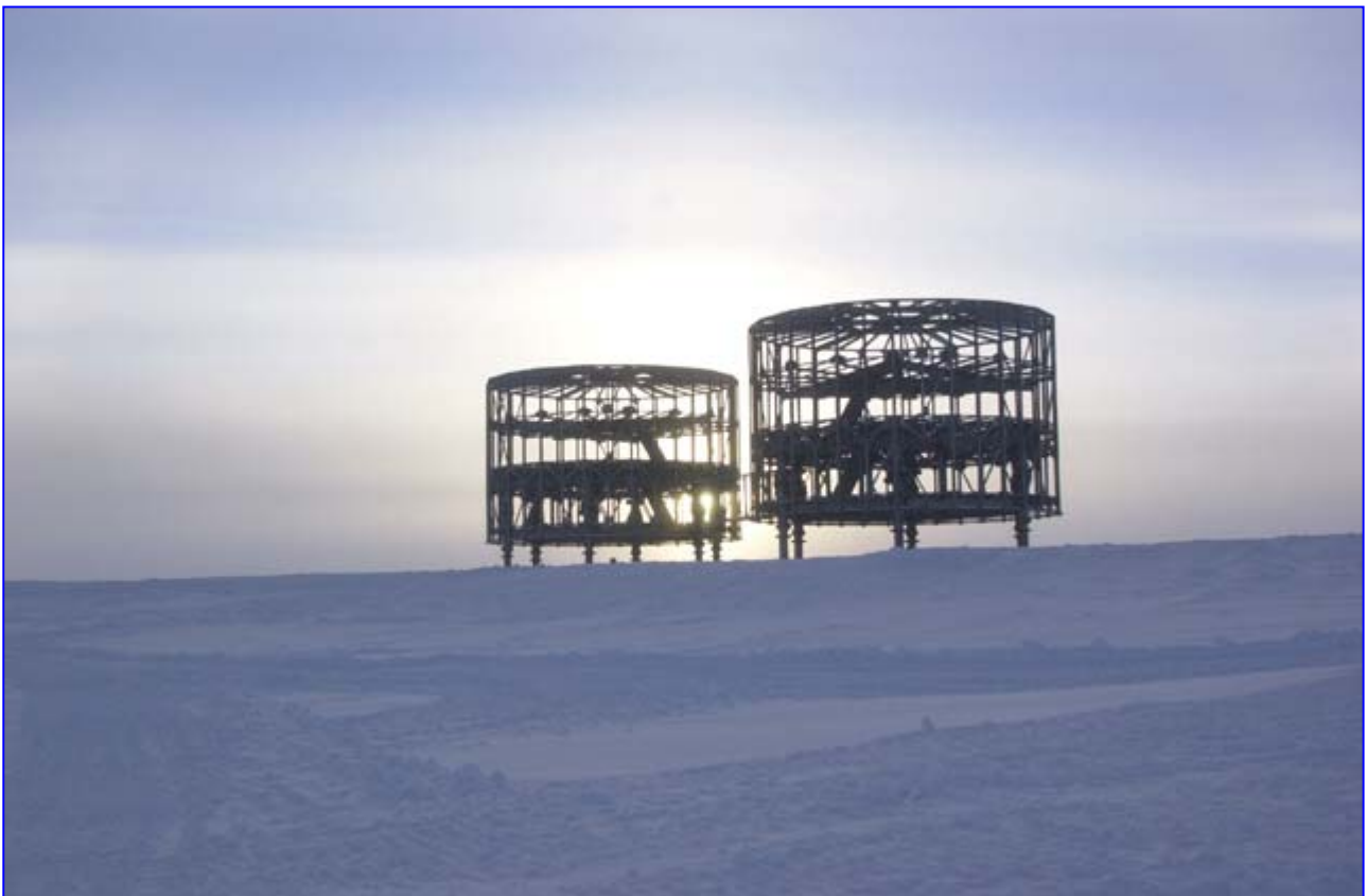
Figura 19: La stazione CONCORDIA in costruzione a Dome C, in Antartide (per cortesia del PNRA).
